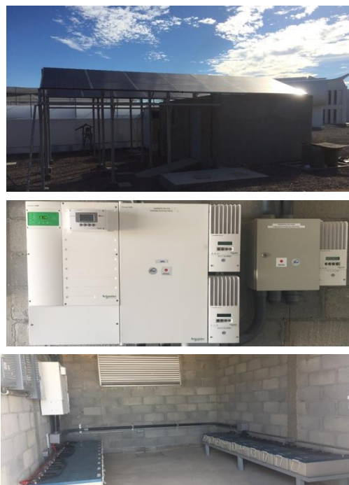
図3 CIBNORモデルにおける太陽光発電システムの機能改善（上）新たに設置した架台に搭載された太陽電池、（中）発電性能に適したインバーター機器、（下）増量されたバッテリー群
